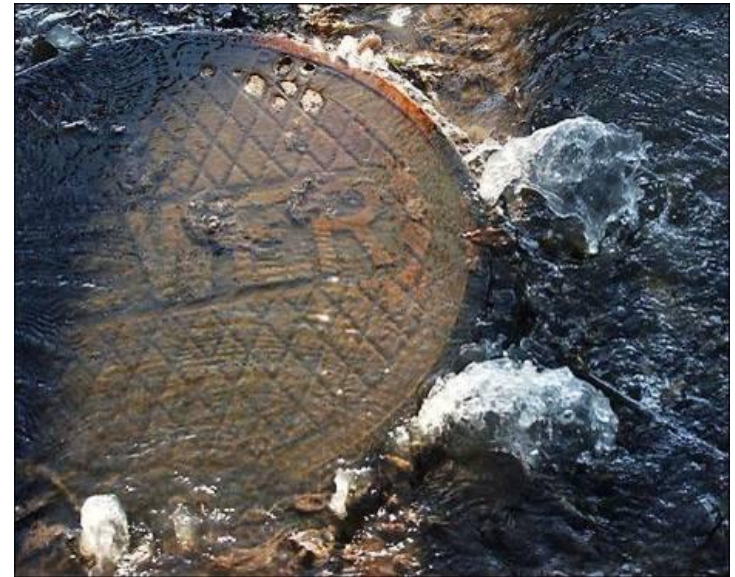
Una alcantarilla tapada hace burbujas en la carretera U.S. Highway 90 en Gulfport.
