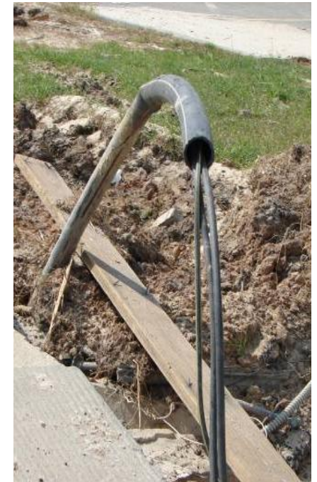
Este es un ejemplo de cables eléctricos dañados y desenterrados.
